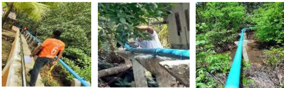
โครงการปรับปรุงท่อส่งน้ำ บ้านมดตะนอย หมู่ที่ ๓
